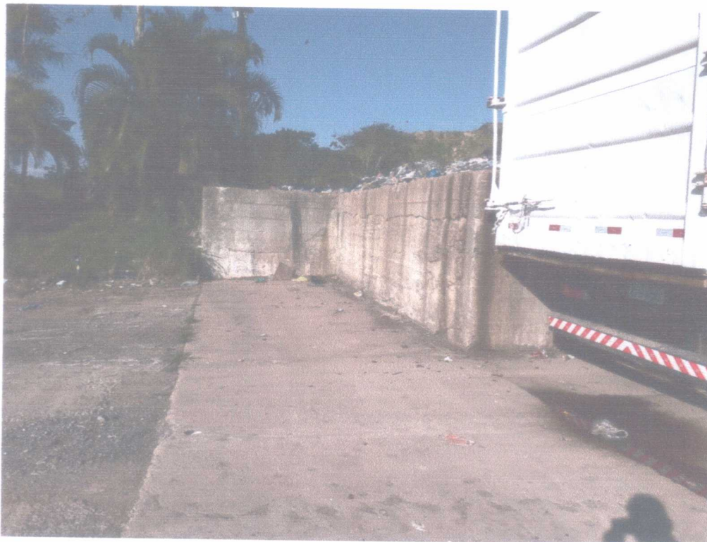
Figura 6 -ÁREA DO TRANSBORDO DE LIXO LOCALIZADA NO PÁTIO DA PEDREIRA MUNICIPAL – DATA DA FOTO 29/08/2018
