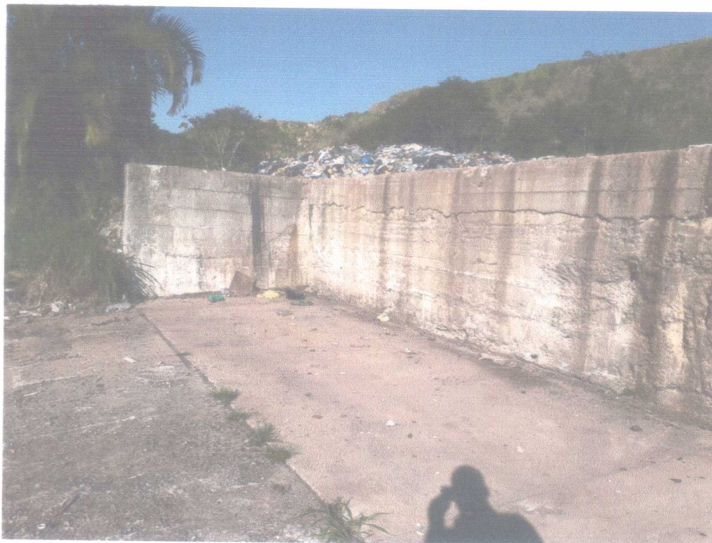
Figura 2 - ÁREA DO TRANSBORDO DE LIXO LOCALIZADA NO PÁTIO DA PEDREIRA MUNICIPAL – DATA DA FOTO 29/08/2018
