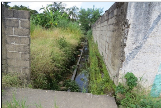
FOTO 23. Tubulação de esgoto à montante da rua Santa Rita, dentro do córrego Ubirajara. Essa instalação representa mais um agravante para as inundações na região.
