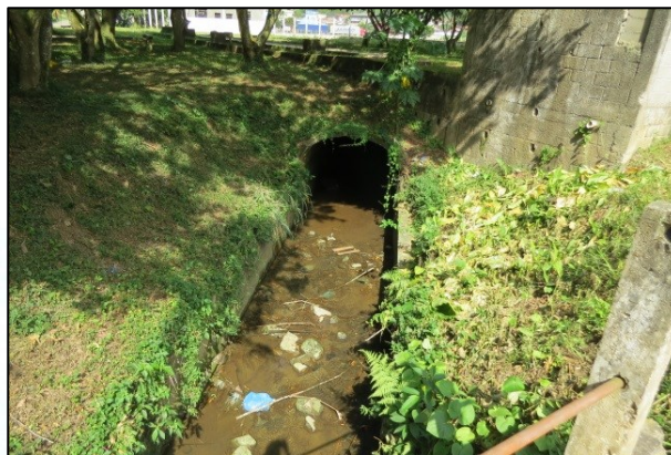
FOTO 26. Galeria de drenagem à jusante do córrego Ubirajara, próximo do campo de futebol. De forma análoga, nota-se a necessidade de limpeza e retificação destas estruturas.
