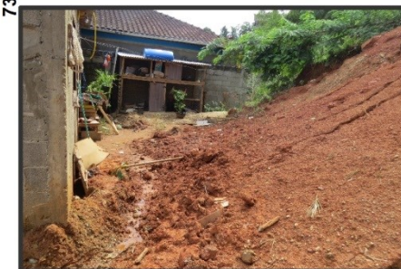
Detalhe do escorregamento de talude de corte na rua Vinicius de Moraes. Notar a surgência d'água na base.
