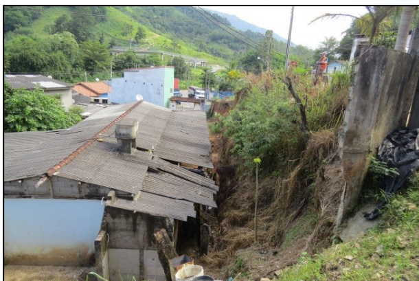
FOTO 31. Talude de corte rente à rua Pixinguinha. Notar a proximidade do talude com a residência na cota inferior e os indícios de escorregamentos pretéritos com a presença de escombros de muros e paredes.
