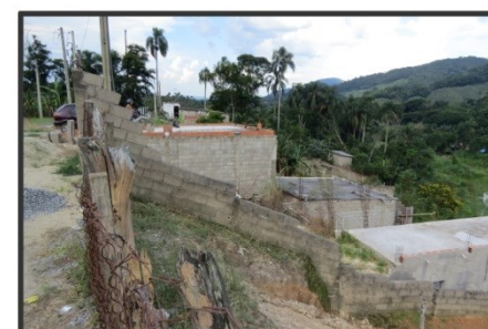
Novas moradias ao fim da rua Adoniran Barbosa. Notar a precariedade do sistema de drenagem na encosta.
