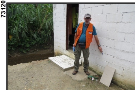
Indicação da cota da última inundação do córrego Ubirajara, na residência. Ela atingiu, aproximadamente, 1 metro em relação ao terreno.
