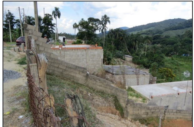
FOTO 34. Novas moradias ao fim da rua Adoniran Barbosa. Notar a precariedade do sistema de drenagem na encosta.
