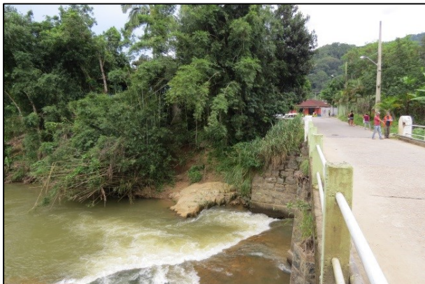
FOTO 45. Ponte de acesso aos bairros Vila São José (ao fundo) e Barra Funda, sobre o rio Bananal. Notar os processos erosivos nas margens.
