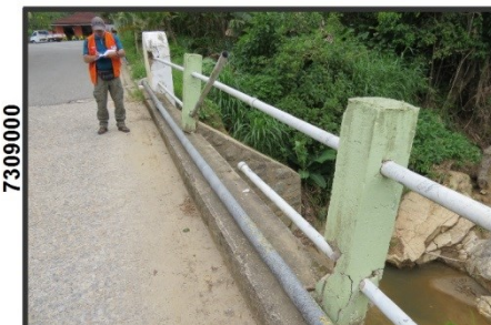
Vista da lateral da ponte. Durante as chuvas intensas do início do ano.
