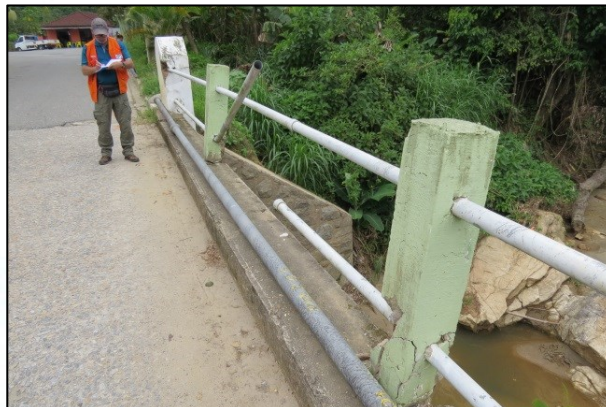
FOTO 46. Vista da lateral da ponte. Durante as chuvas intensas do início do ano, a ponte sofreu galgamento, com a destruição da sua proteção lateral, conforme se observa na foto.
