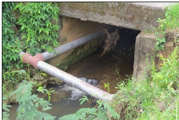
FOTO 22. Detalhe da tubulação de esgoto instalada dentro do córrego, o que dificulta o escoamento do fluxo e acumula lixo sob a ponte, potencializando a inundação neste local.
