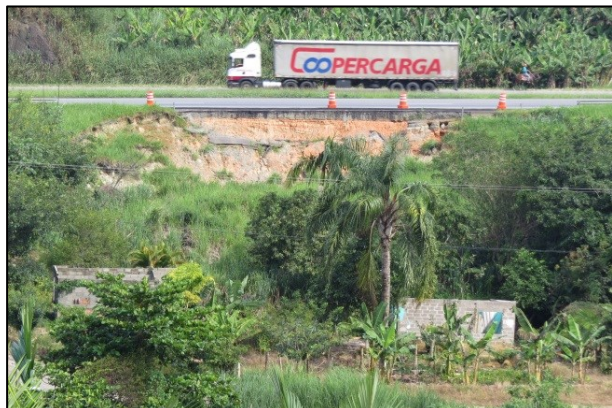
FOTO 27. Vista geral de escorregamento de talude da rodovia Régis Bitencourt em direção à rua Vinicius de Moraes. Notar a residência atingida ao “pé” do talude.
