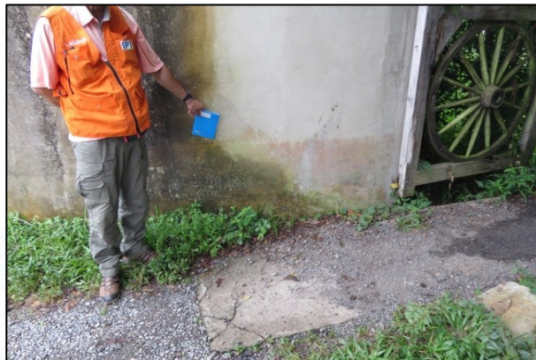
FOTO 58. Indicação da cota atingida pela última inundação do rio São Lourenço, ocorrida ainda neste ano.
