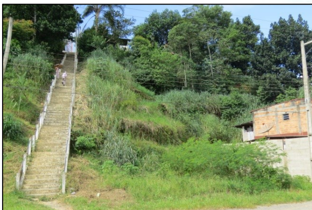
FOTO 11. Aspecto do acesso entre a rua Antônio M. de Castro (abaixo) e a rua Gov. Lucas N. Garcês (acima). Observar as cicatrizes de escorregamentos em taludes de corte.
