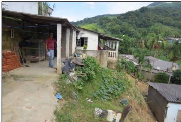
FOTO 30. Indícios de movimentação do terreno entre as moradias. Notar a precariedade do sistema de drenagem, o lançamento de esgoto a céu aberto e entulho e lixo depositado na encosta.
