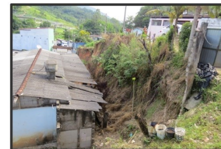
Talude de corte rente à rua Pixinguinha. Notar a proximidade do talude com a residência na cota inferior e os indícios de escorregamentos pretéritos com a presença de escombros de muros e paredes.
