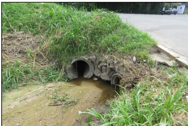
FOTO 25. Tubulações de águas pluviais em ponto onde ocorre inundação. Notar o assoreamento e necessidade de limpeza do local..
