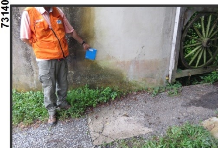
Indicação da cota atingida pela última inundação do rio São Lourenço, ocorrida ainda neste ano.
