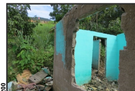
Residência atingida por escorregamento do talude da rodovia. Não houve vítimas. A casa vizinha também foi desocupada após este evento.
