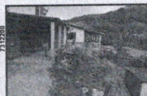
Indícios de movimentação do terreno entre as moradias.
