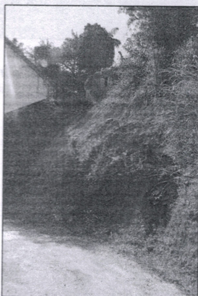
FOTO 15. Aspecto de talude de corte sujeito ao processo de escorregamento no morro da Sudelpa. Notar a distância entre as moradias.
