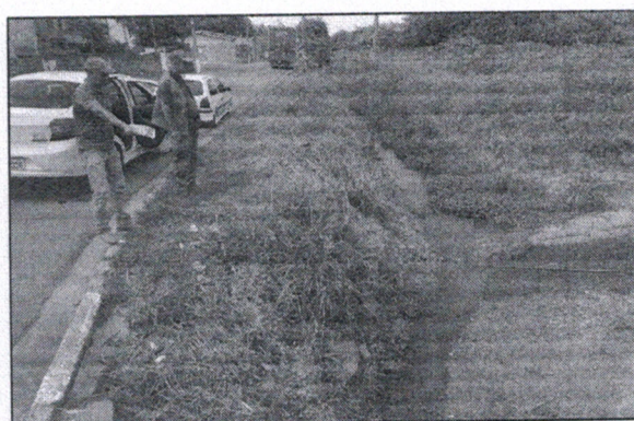
FOTO 24. Córrego Ubirajara próximo à rua Vinicius de Moraes. Este ponto recebe contribuição da drenagem da rodovia Régis Bittencourt, à direita da imagem.
