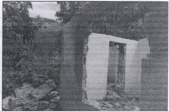
FOTO 28. Residência atingida por escorregamento do talude da rodovia. Não houve vítimas. A casa vizinha também foi desocupada após este evento.
