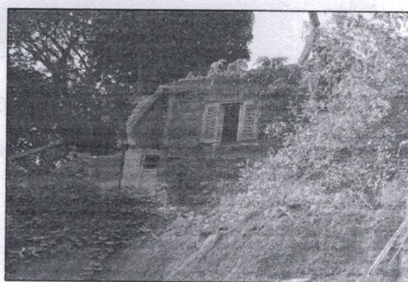
FOTO 16. Detalhe de residência no topo do morro da Sudelpa, parcialmente destruída por deslizamento de terra. Nota-se que o processo permanece ativo neste local, ameaçando as edificações abaixo deste ponto.
